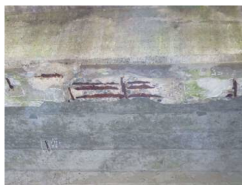
鉄筋の露出状況
