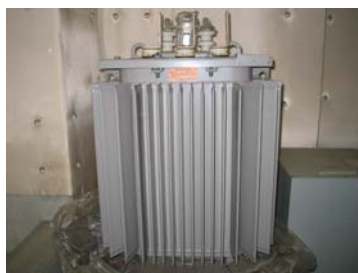
高圧トランス
