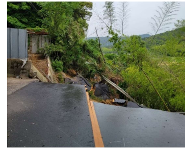
・道路崩壊状況（6月2日）
