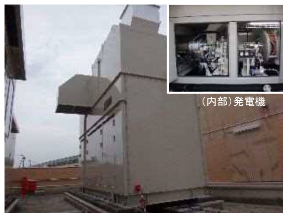
【非常用自家発電設備の整備】
