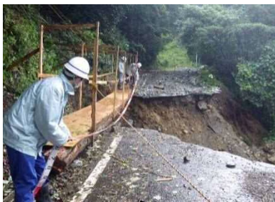
【被災状況調査】 (熊本県五木村)
