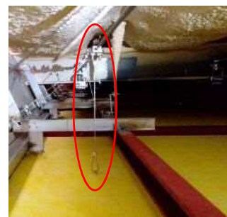
落下防止措置（天井裏）
