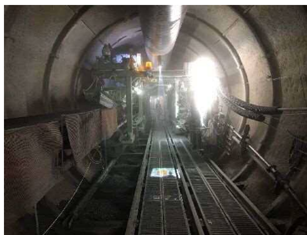
【豊川用水二期事業の実施状況】 (独立行政法人水資源機構)
