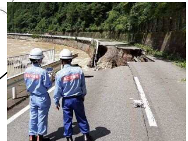
【ドローンによる被災状況調査】 (岐阜県下呂市)
