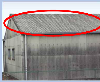
石綿含有成形板等(レベル3)
