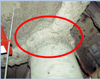
吹付け石綿(レベル1)
