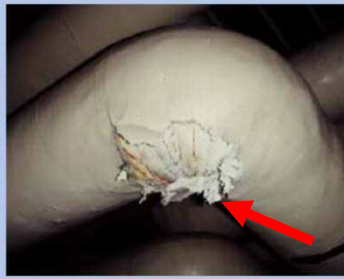
石綿含有断熱材・保温材・耐火被覆材(レベル2)
