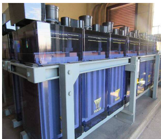
【老朽化した電話交換機用蓄電池】
