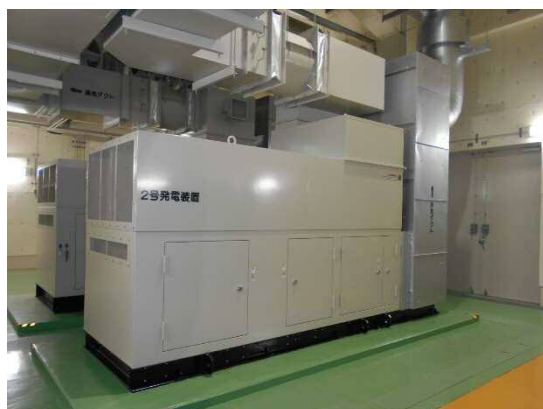
【非常用自家発電設備の整備】
