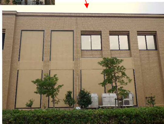
【処理場施設の耐震化】
