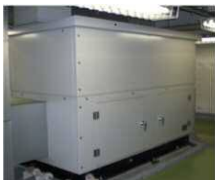
【非常用発電機（東三河総合庁舎）】
