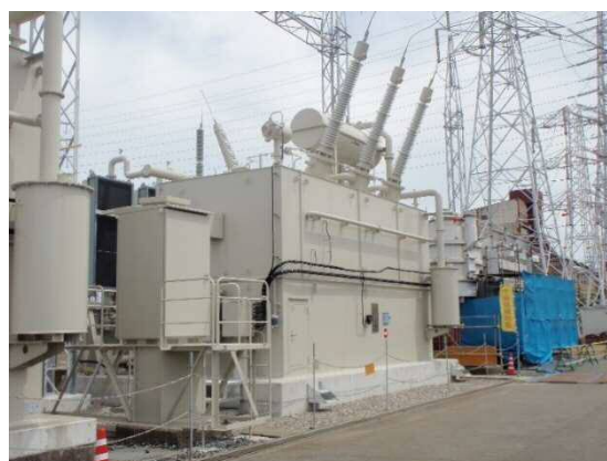
【昭和町変電所】
