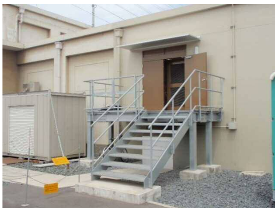
【昭和町変電所】
