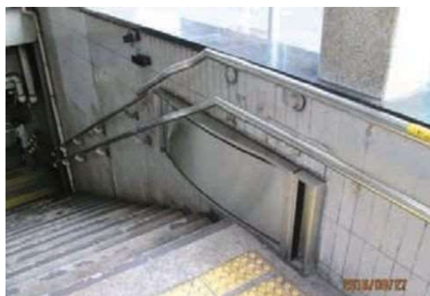
写真21 止水板（地下鉄千種駅） （2016.8.27撮影）
