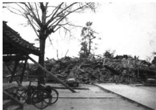
写真10 東南海地震では灯笼などが倒れる程度ですんだが(上)その後直下に起きた三河地震では完全に倒壊した(下) (碧南市康順寺本堂の様子、同市・原田三郎さん撮影) 出典 広報ぼうさい No.44 (内閣府(防災担当), 2008)
